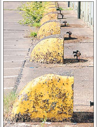
Abstandhalter: Große Betonpoller schützen ein die Haltehäken der Garagentore vor allzu übermütigen Lastwagenfahrern.
